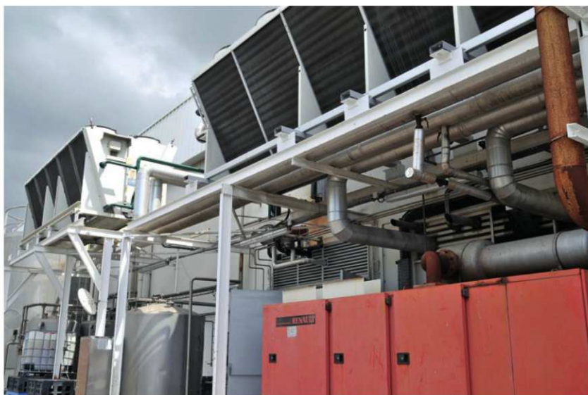
Le nouveau système de réfrigération installé chez SORELAIT est efficace et économe en énergie / The new cooling system installed at SORELAIT is efficient and saves energy (doc. ALFA LAVAL).
