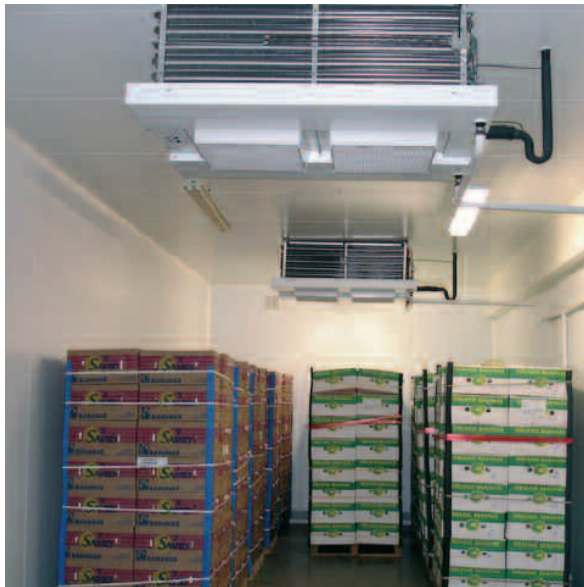
Chambre pour maturation et refroidissement rapide.
